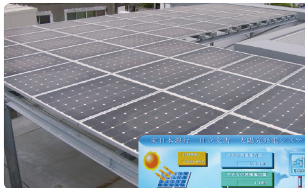
太陽光発電装置 (日立支店)
