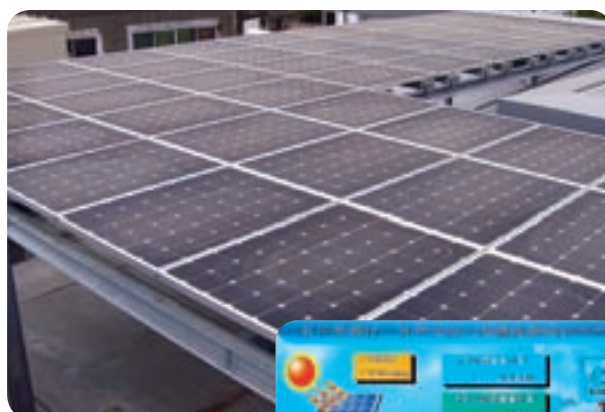
太陽光発電装置（日立支店）
